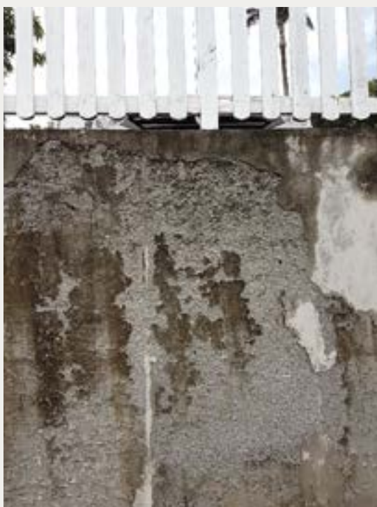
Ecaillage à la surface d'un mur de soutènement © Loïc Divet
