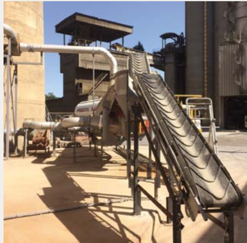
Démonstrateur installé dans le cadre de FastCarb à la cimenterie LafargeHolcim du Val d'Azergues. fastcarb.fr
