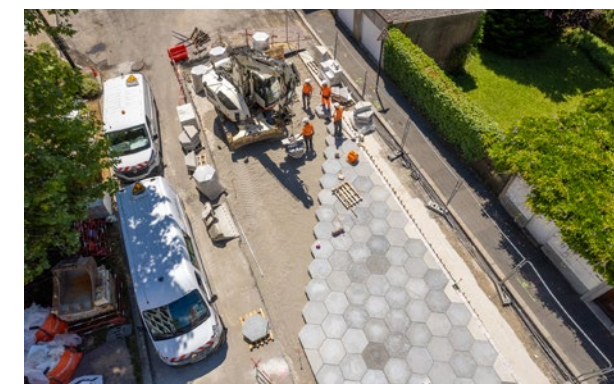
Le démonstrateur de CUD-SF de Nantes en cours de montage vu du ciel. ©Eiffage Route
