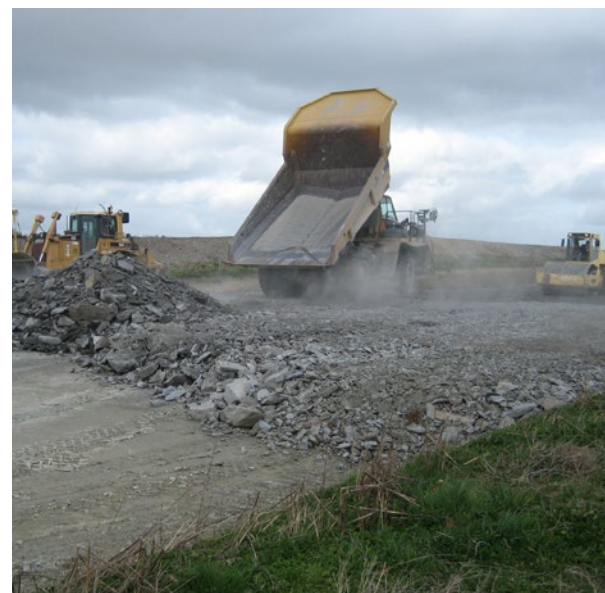
Couche de forme et partie supérieure des terrassements en matériaux granulaires © Yasmina Boussafir, Université Gustave Eiffel
