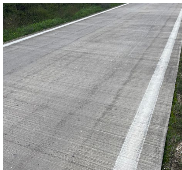
Vue de la moquette BHP après 7 ans de circulation (Auxerre, 2022) © Christophe Chevalier/Agilis
